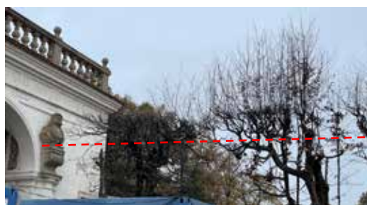
Původně zamýšlená výška stěn je pořád příliš vysoká a je to vada, která musí být napravena. Pravá strana kolonády. 11.10.2022.
